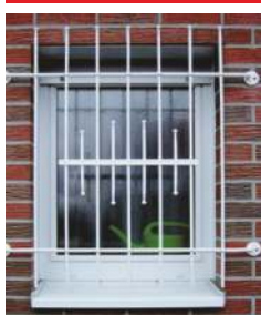
Einbruch- und Hochwasserschutz
